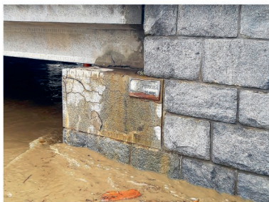
15. září zasáhly naše území povodně. Nejvíce postižená byla severní Morava, hlavně Jesenícko. Olšava pod mostem do Podolí kulminovala na 519 cm, tedy asi 30 cm pod nejvyšší hodnotou při povodni 1997.
